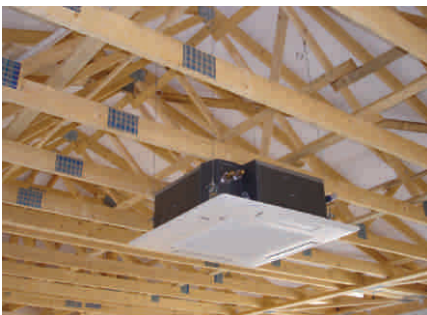
Unidades de ar condicionado
