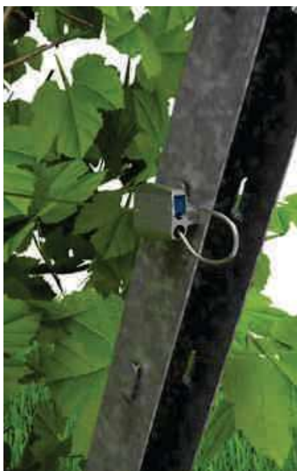
VIT-S - Instalado em postes de metal
